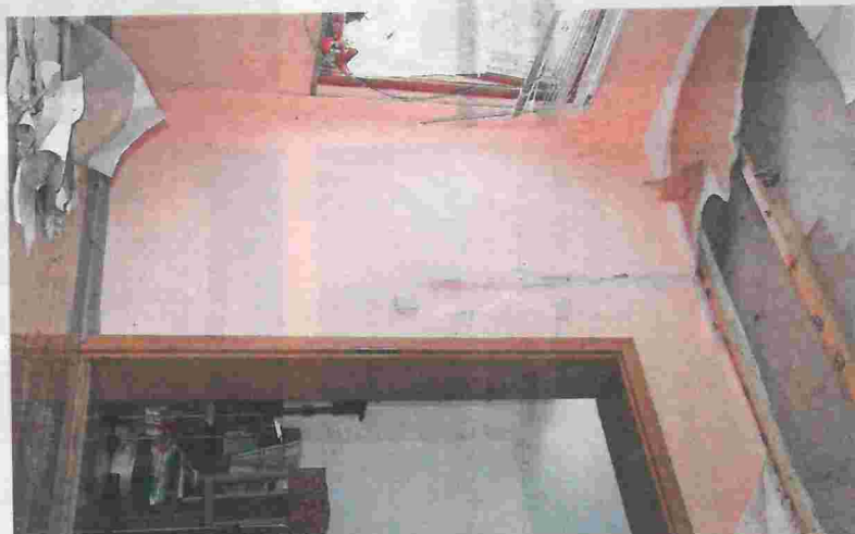
„Nicht mehr bewohnbar“ lautet das einheitliche Urteil zum Zustand des Hauses.
