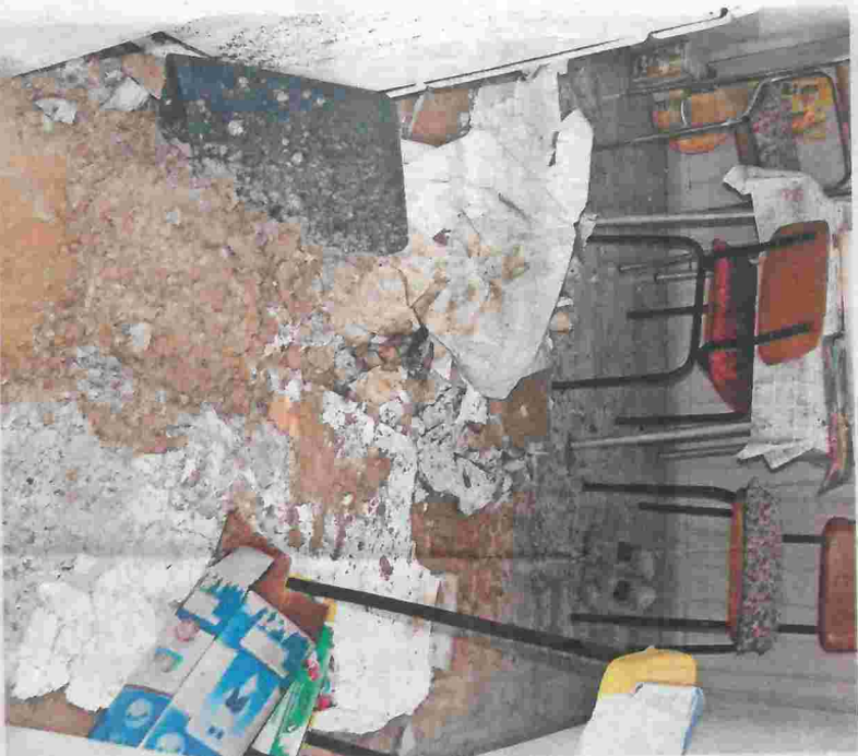
Die aufgeweichten Zwischendecken geben nach und fielen auf den Küchenboden im mittleren Stockwerk.
